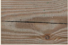
Spanningsscheurtjes door de houtdroging
