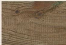
Ruwe plekken op het houtoppervlak
