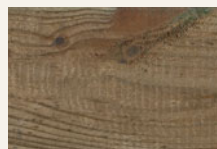
Ruwe plekken op het houtoppervlak
