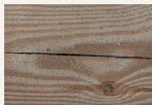
Spanningsscheurtjes door de houtdroging
